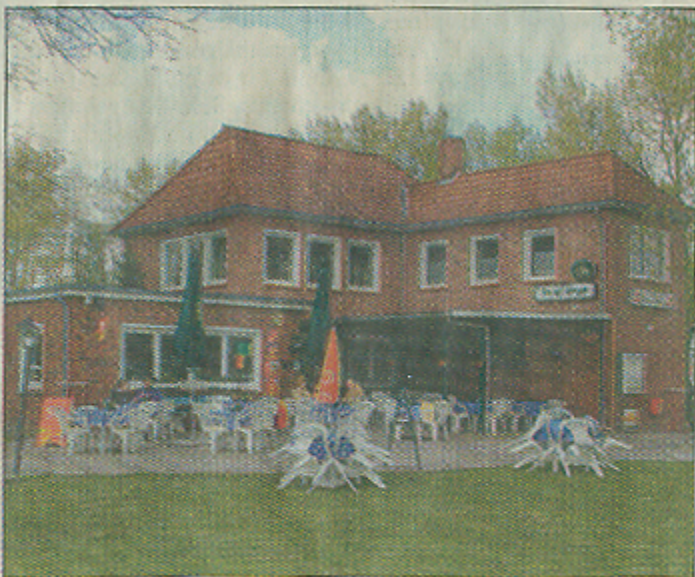
Ein Anbau der Gaststätte „Luv up“ im Jemgumer Hafen sackt in Richtung Ems ab. Bei der Ursachenforschung wird auf die Flußvertiefungen verwiesen. Foto: pnv
