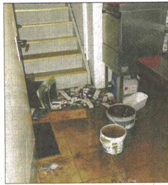
Bis auf die ersten Stufen der Treppe stand im Erdgeschoss das Wasser.
